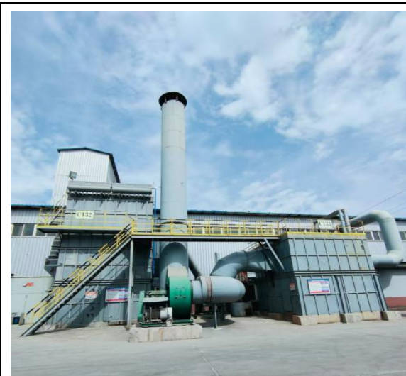
1#生产线输棉布袋除尘及转载点环境布袋除尘
