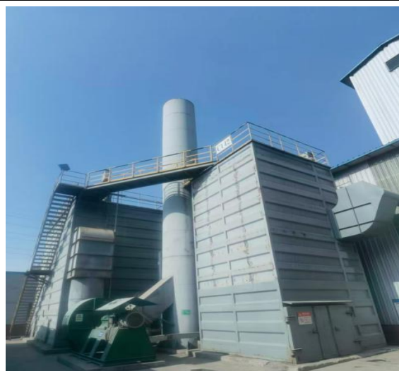
3#生产线输棉布袋除尘及转载点环境布袋除尘
