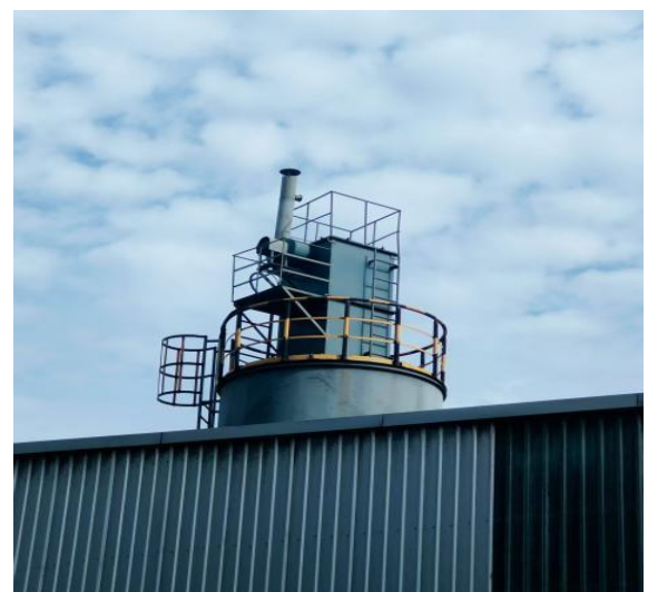
水泥筒仓布袋除尘器
