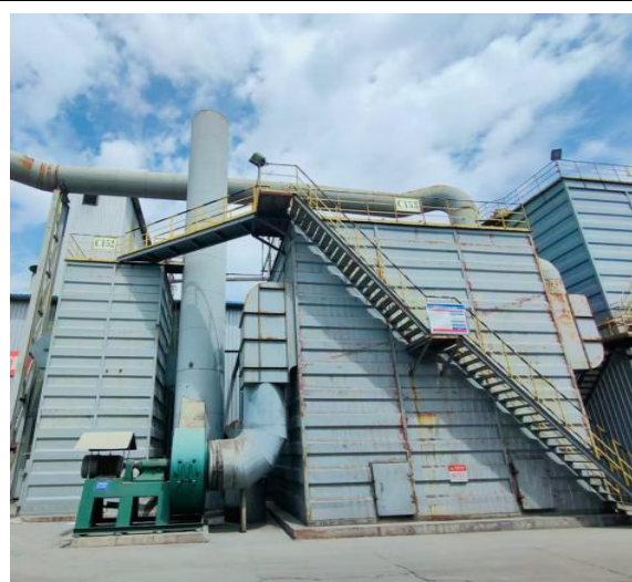
4#生产线输棉布袋除尘及转载点环境布袋除尘
