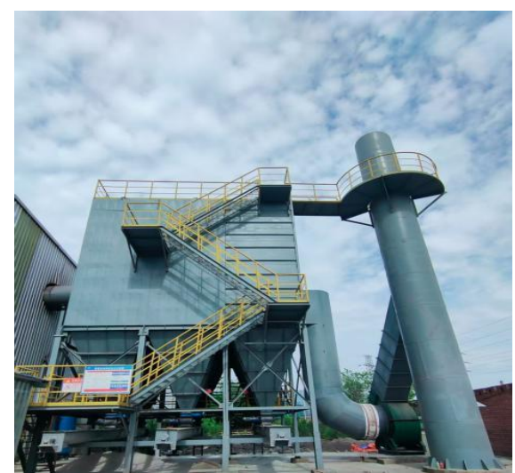
压块工序布袋除尘器
