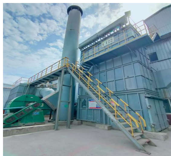
2#生产线输棉布袋除尘及转载点环境布袋除尘
